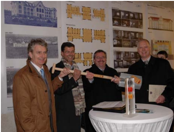
Bild 1: v.l.n.r.: Staatssekretär Prof. Dr. Christian Juckenack, Stiftungsvorstand Michael Hasenbeck, Oberbürgermeister Stefan Wolf und Dr.-Ing. Wolfgang Berger während des symbolischen Spatenstichs im großen Saal der Max-Zöllner-Villa
