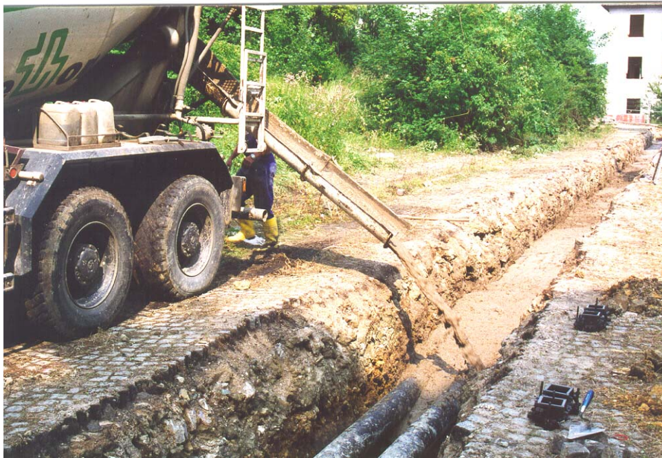
Bild 1: Feldversuch Stadtwerke Weimar, Lützendorfer Str., Einbau von Boden-Mörtel in die Leitungszone einer Fernwärmeleitung KMR 2 x DN 150 in Nebeneinanderverlegung
