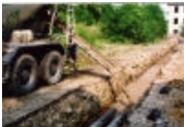
Abb. 1: Netzversuch Stadtwerke Weimar, Einbau von Verfüllmörtel in die Leitzone einer KMR-Leitung 2 x DN 150 in Nebeneinanderverlegung
