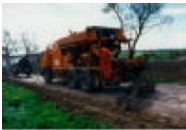
Abb. 2: Netzversuch Tonndorf, Gasversorgung Thüringen, Herstellung und Einbau von Verfüllmörtel mit einer Schlammemaschine
