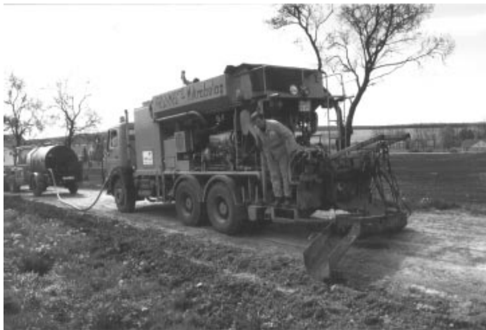
Bild 3: Feldversuch Tonndorf, Gasversorgung Thüringen, Herstellung und Einbau von Boden-Mörtel mit einer Schlammemaschine
