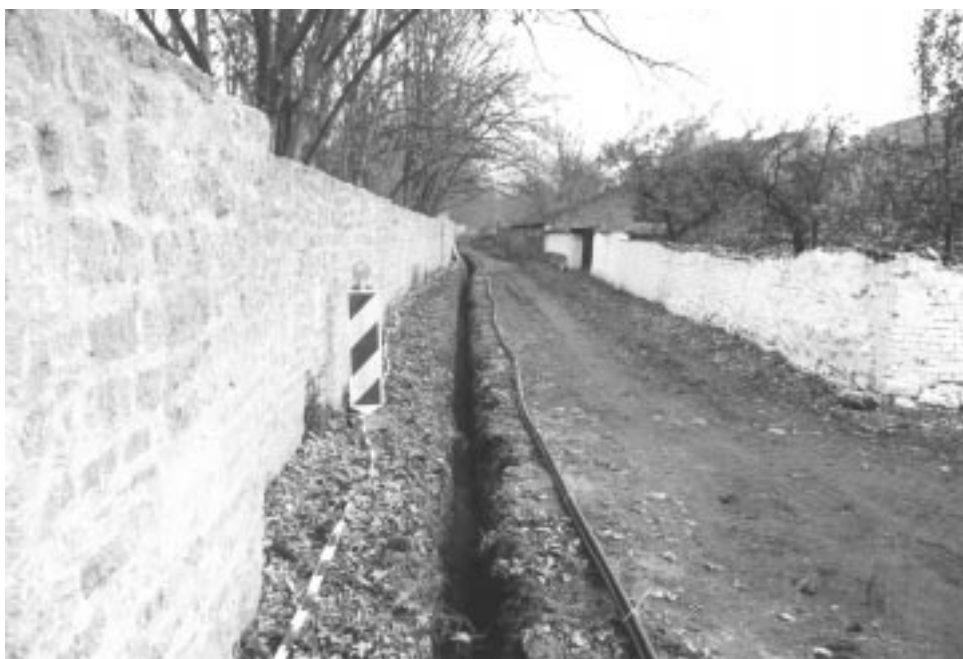
Bild 7: Leitungsgaben und vorbereiteter Verbund aus drei Starkstromkabel vor dem Ablegen auf die Grabensohle aus Sand
