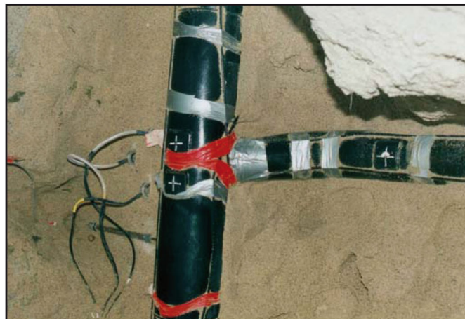
45°-T-Abzweig im Leitungsgraben nach Versuchsende
