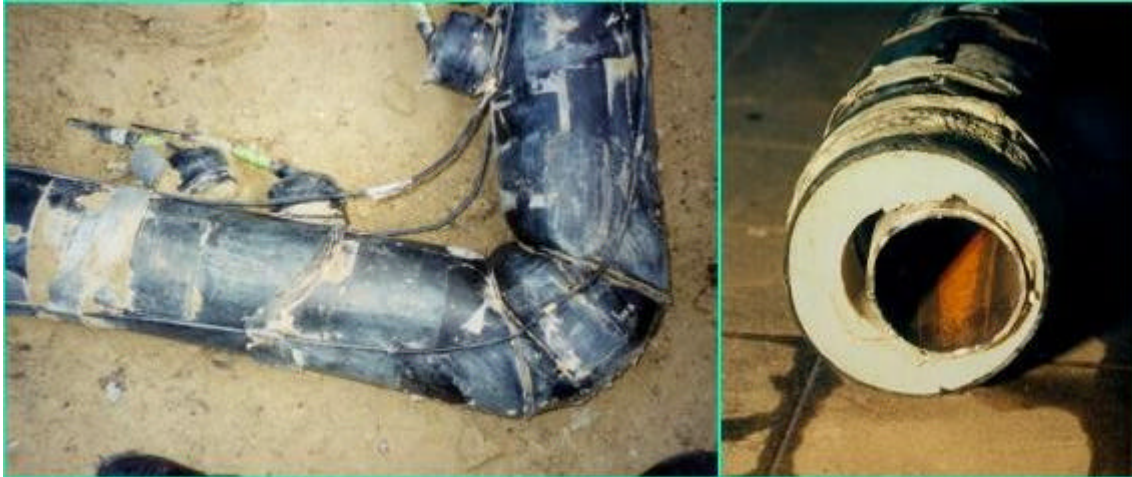
Zustand des beanspruchten Rohrbogens (links) und des Verbundes (rechts) nach Abschluss des Grenzzustandsversuches
