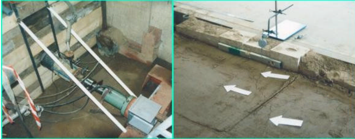
Blick in die Pressgrube (links), Erdbrüche im Bogenbereich (rechts)
