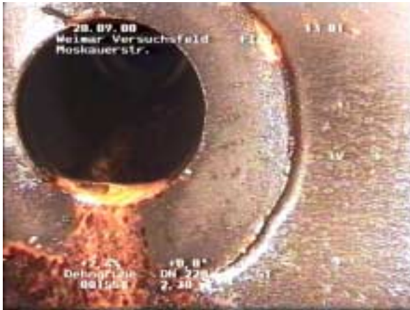
Bild 12: Riss im Schweißnahtbereich des Anbohrkugelhahns DN 25 im Ergebnis des Grenz-zustandsversuches nach 122 mm Pressweg
