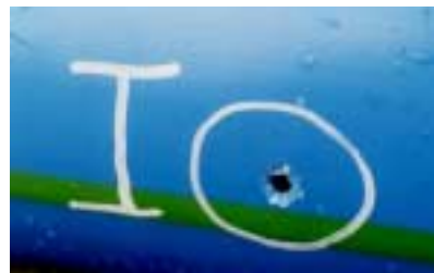
Bild 9: Rohrleitung mit Leckage
