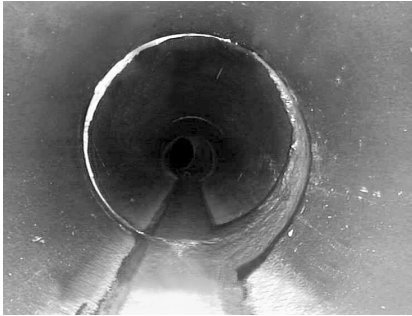
Bild 4: UCFR – primärer Schaden HI I -R – sekundärer Schaden
