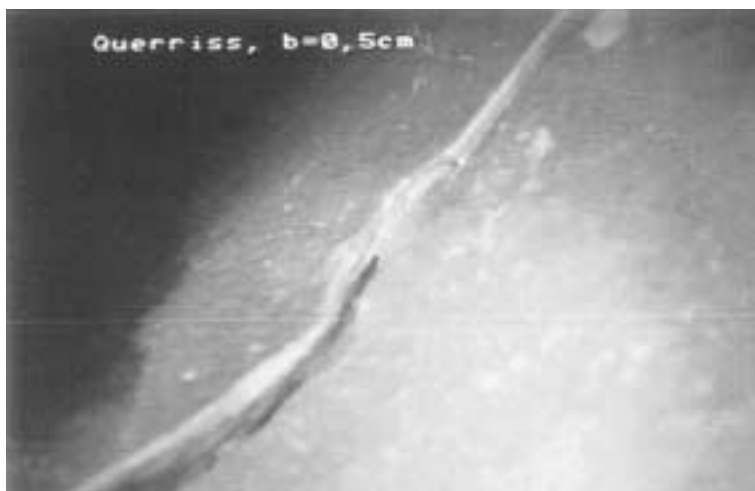
Bild 2b: Schadensbild „Querriss“
