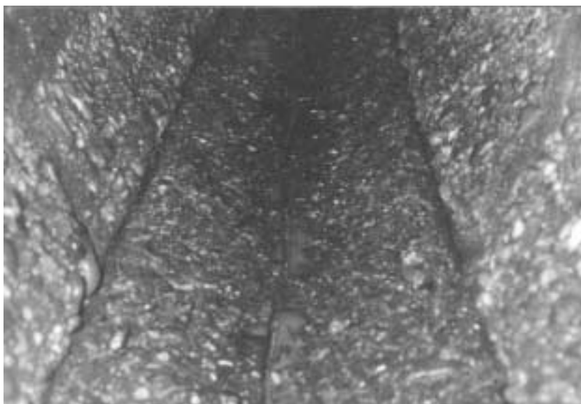
Bild 1: Geschädigter Gerinnebeton des Modellkanals nach über 100-jähriger Betriebsdauer
