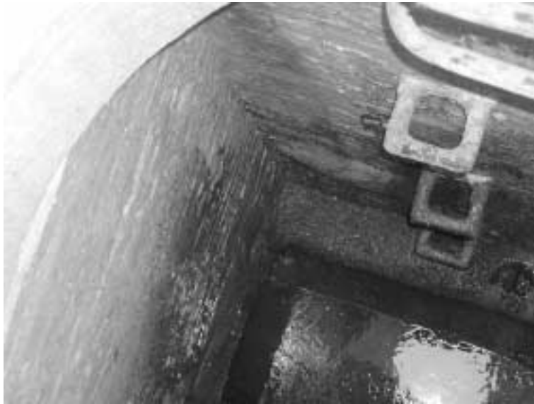
Bild 6: Blasenbildung in einer Beschichtung aus Polyurethan
