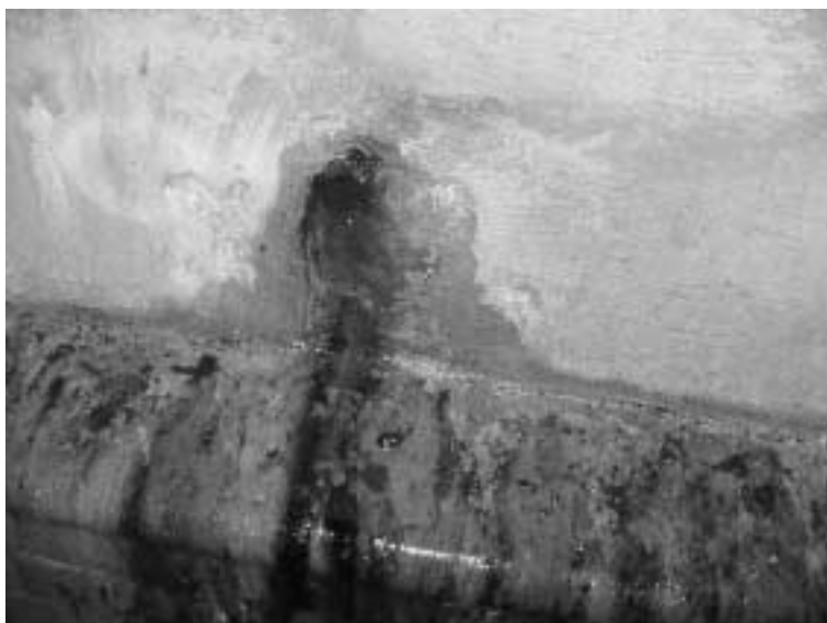
Bild 2: Undichtigkeit in einer Mörtelbeschichtung
