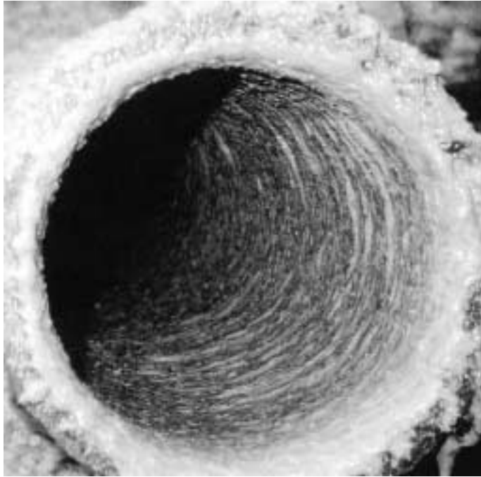
Bild 5: Mit Zementmörtel ausgekleidete Rohrleitung
