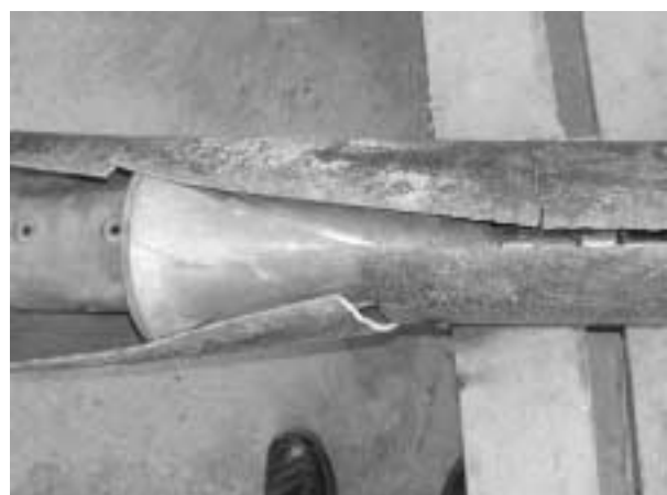
Bild 10: Undefinierte Verformungen beim herkömmlichen Auftrennen von duktilen Gussrohren
