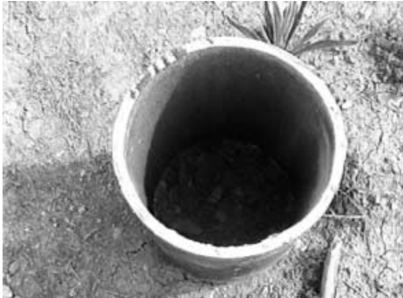
Bild 11: Abgetrenntes Rohrsegment, keine Ablösungen oder Ringspaltbildung
