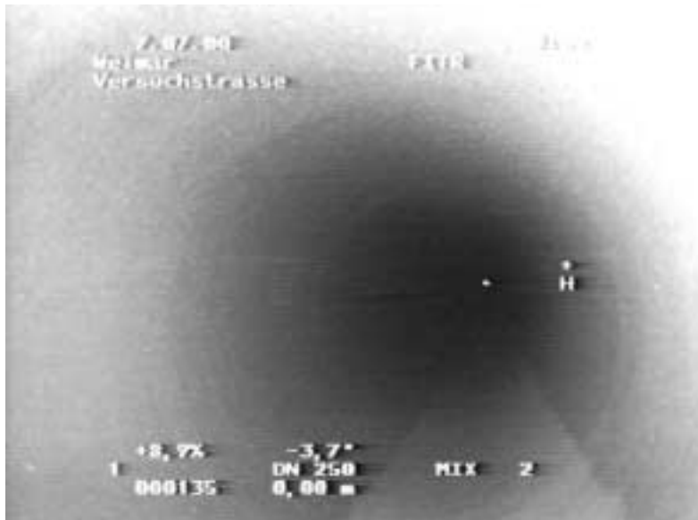
Bild 9: Typischer Zustand der Innenbeschichtung vor den Temperaturlastwechseln
