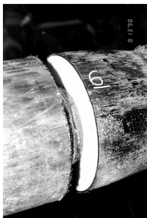
Bild 6: Zustand des PUR-Schaumes des ersten KMR-Probanden DN 150 im Bereich der Schrumpfmuffe in 6-Uhr-Position nach insgesamt 337 Verschiebezyklen in Weimarer Bau-Mörtel®
