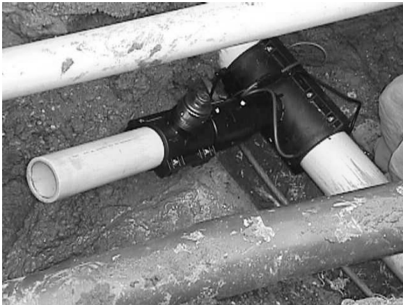
Bild 1: Überschieber KÜS, auf einer Gasleitung verschweißt
