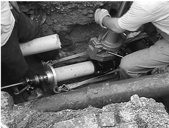
Bild 2: Versorgungsleitung unter Druck angebohrt und die Abgangsleitung mit Blasensetzgerät abgesperrt (alternativ: Quetschen der Abgangsleitung möglich)
