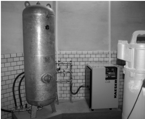
Bild 3: Anlage zur Druckluftentspannungsspülung
